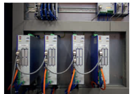
Die kompakten Steuer- und Antriebskomponenten sorgen für einen aufgeräumten und damit übersichtlichen Schaltschrank.
